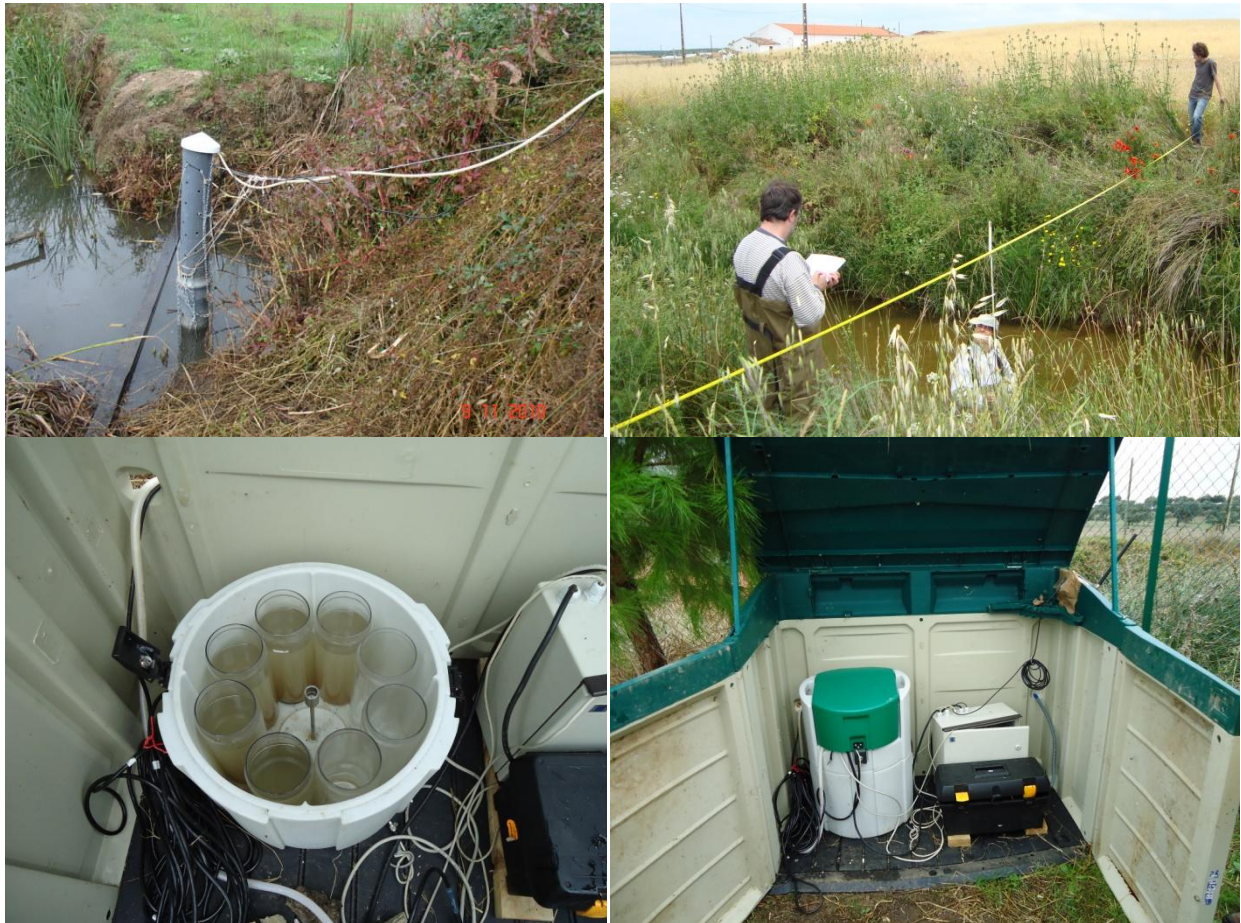
Figura 1.13. Estação automática de monitorização da água no rio Enxoé. Nas fotos superiores pode ver-se parcialmente a sonda ISY e a medição da geometria do leito do rio. Na parte inferior da figura apresenta-se o colhedor automático de amostras.
